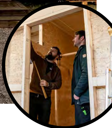
Till höger: Alexander Gergesa och Fabian Bräuer planerar hur de ska sätta björkplywood till interiören.
